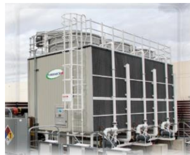
日本で初めての導入となった Supermicro の液冷クーリングタワー
